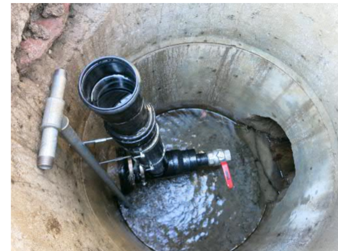
Staurohr im bestehenden Schacht (3.974)
