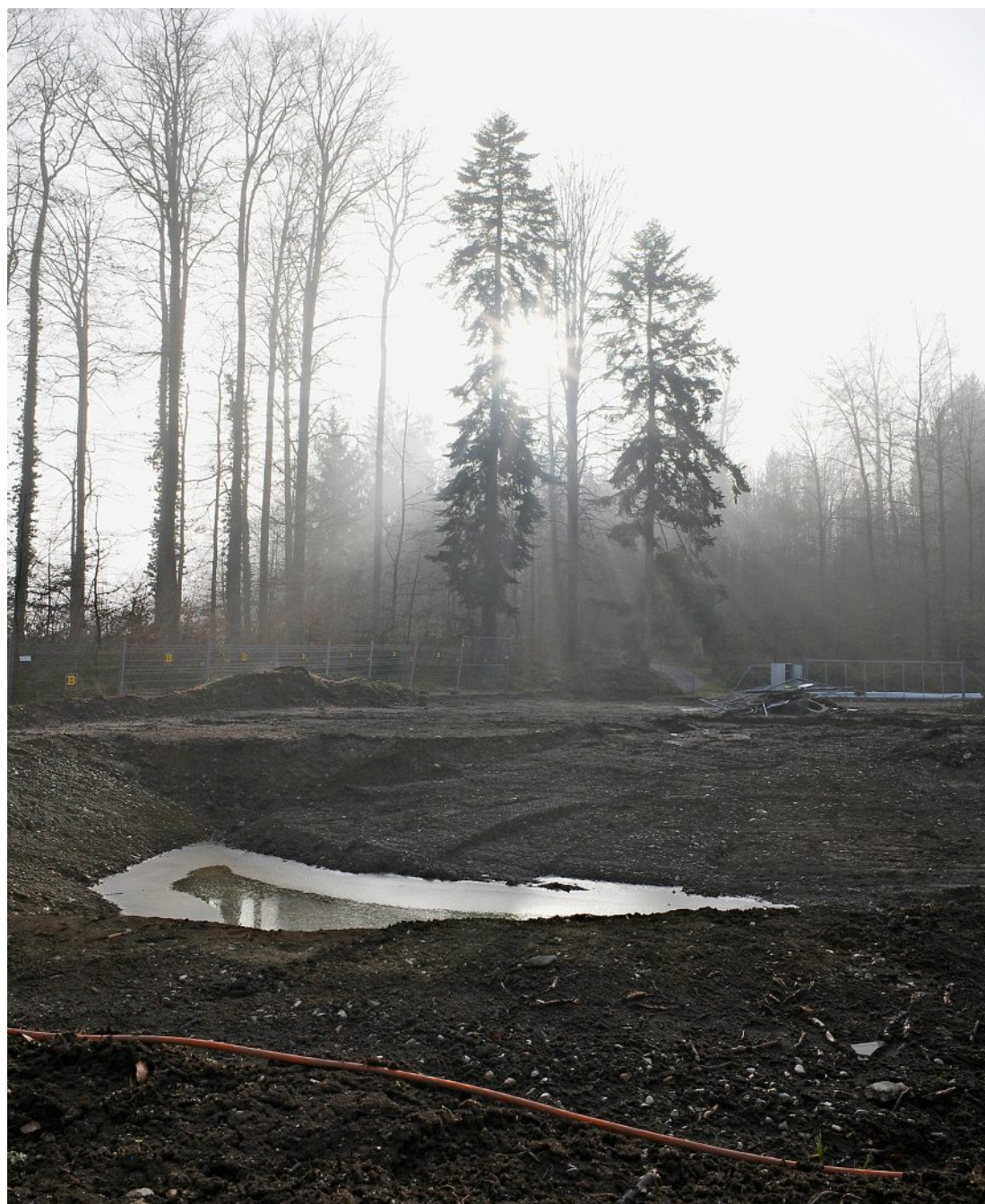
Wo vorher ein Schalthaus und eine Starkstromanlage standen, soll ein Teich entstehen. Foto: Moritz Hager
